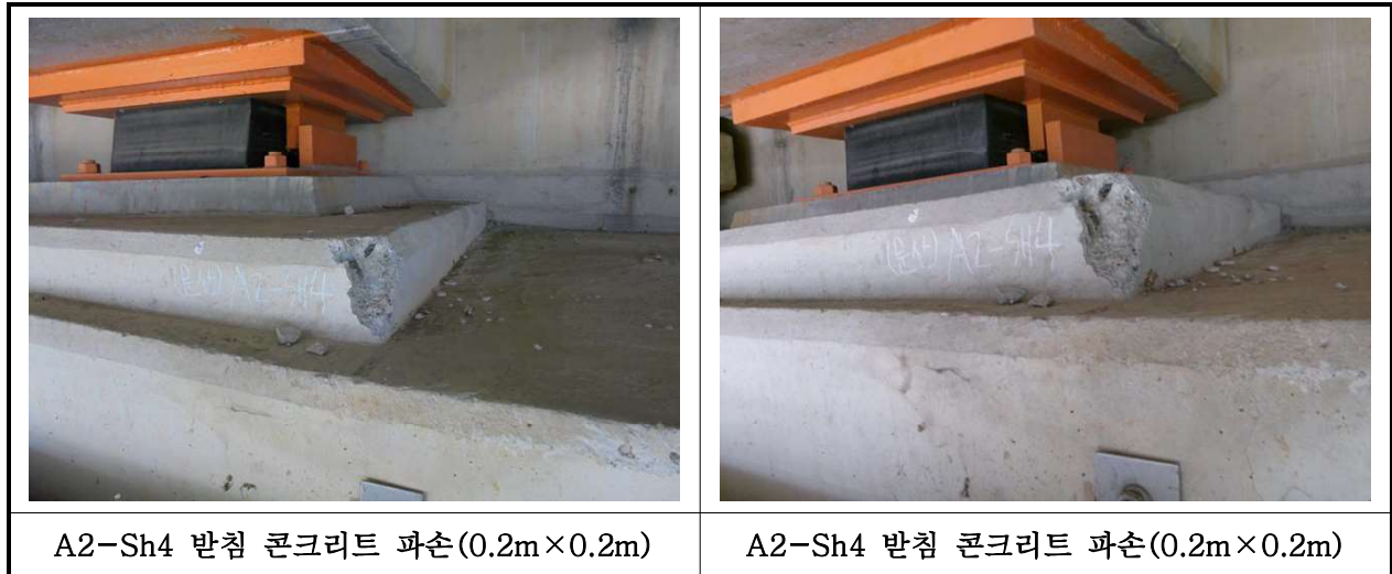
【사진 8.3.13】 교량받침 손상현황
